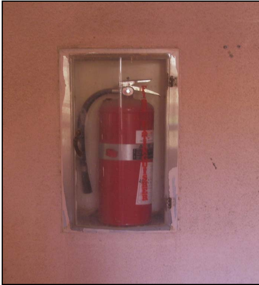
تثبيت طفاية الحريق داخل تجويف جداري على ارتفاع متر
